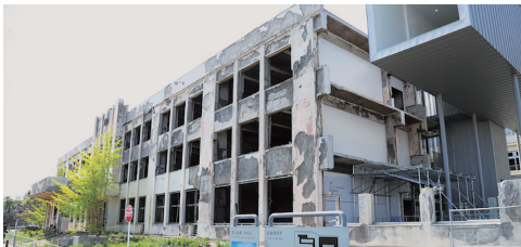
写真-1 震災遺構門脇小学校（本校舎）
