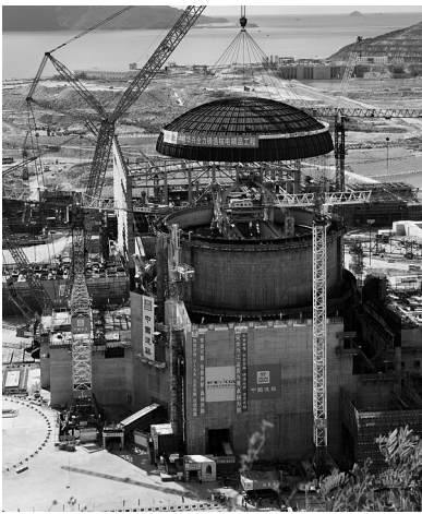
台山2号機の丸屋根設置作業の様子。建設現場の様子が写っている。
