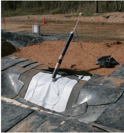
②地下貯水槽に設置される漏えい検知システム。検知孔貫通部の不具合が漏えい原因の可能性の一つとみて、念入りに調査が行われている。
