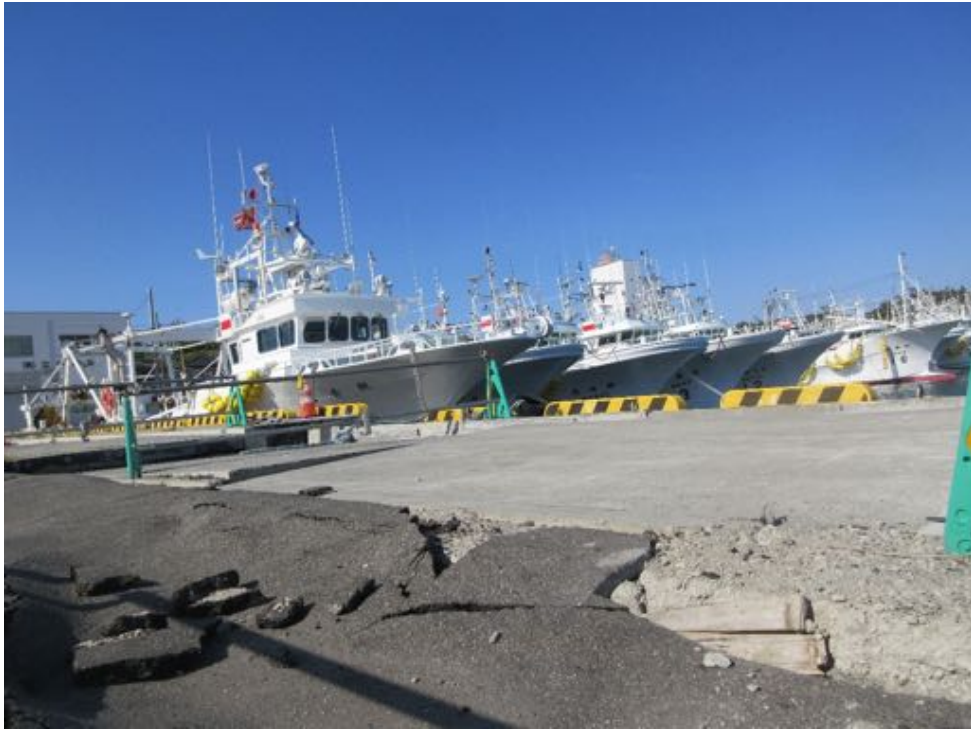
【地震でガタガタになった岸壁（相馬市松川浦漁港）】
