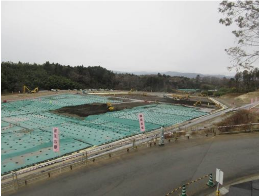
【中間貯蔵施設内の土壌貯蔵施設（大熊町）】
