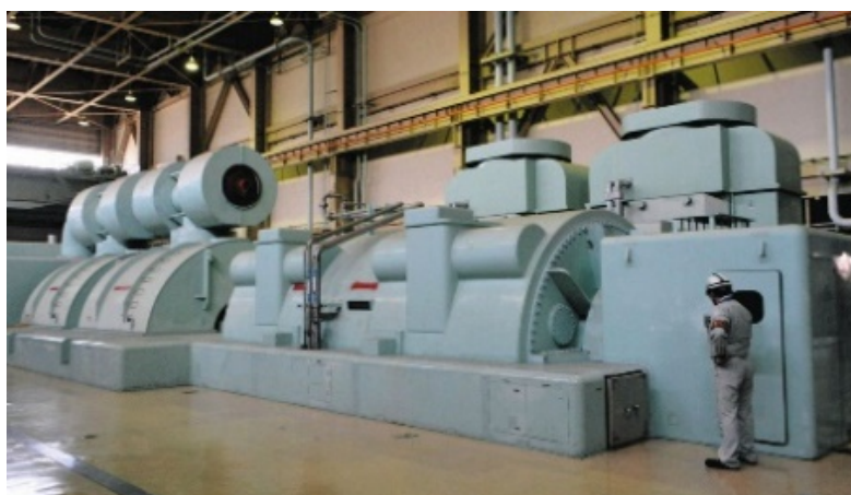
廃炉作業が進む「もんじゅ」で今後、解体撤去されるタービン発電機=6月1日、福井県敦賀市で
