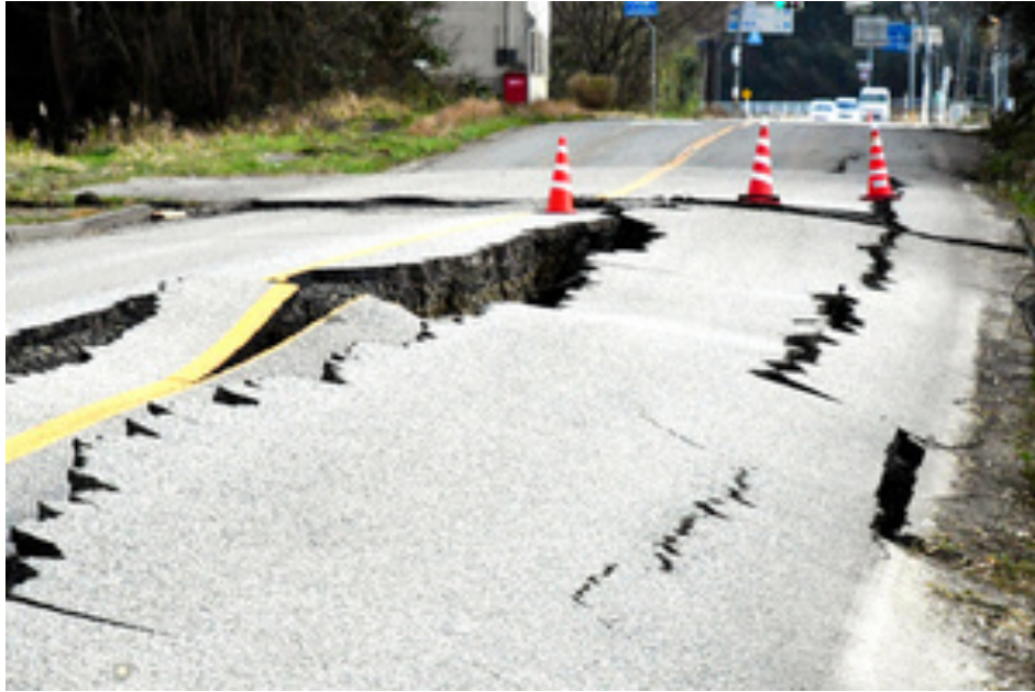
北陸電力志賀原発から北に約 10 キロの国道 249 号は、片側が大きく陥没し、通行できなくなっていた=2024 年 1 月 5 日午後、石川県志賀町、佐々木凌撮影（「朝日新聞デジタル」2024 年 1 月 16 日 21 時 00 分）
