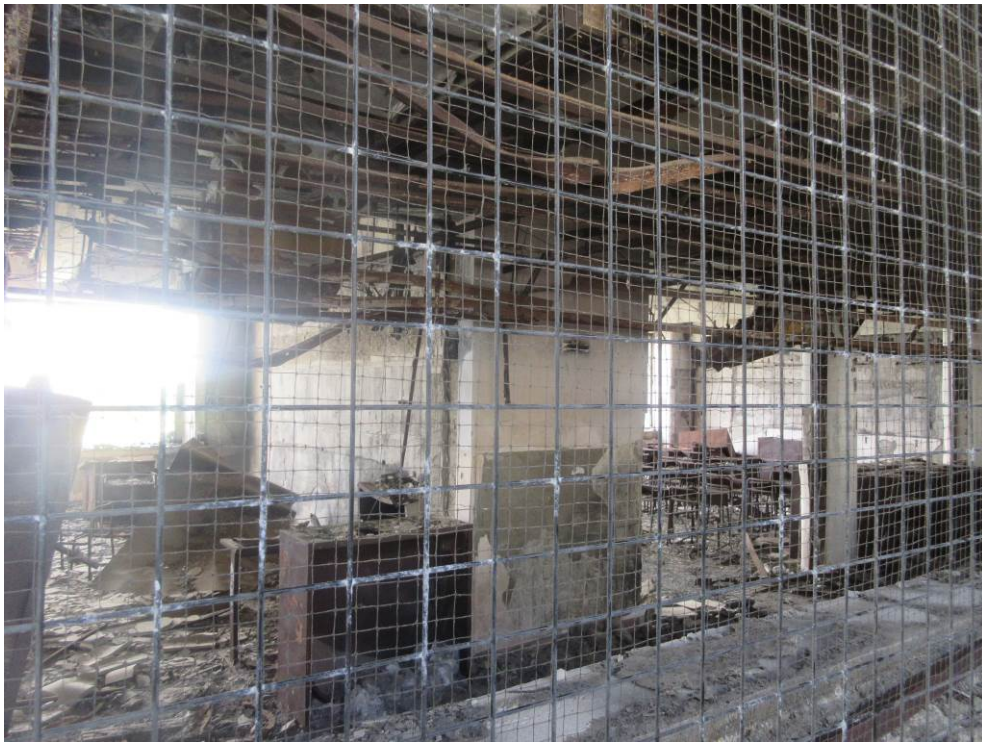
【津波で被災した職員室】
