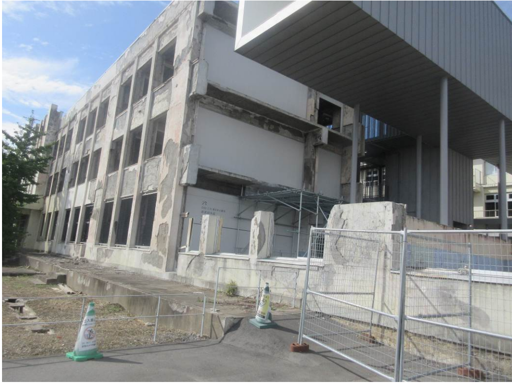
【1階が津波で、2・3階が火災で被災した門脇小学校】
