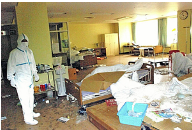
【双葉病院東病棟1階のデイルーム多くの患者がここに集められ救出を待った(11年3月)】
